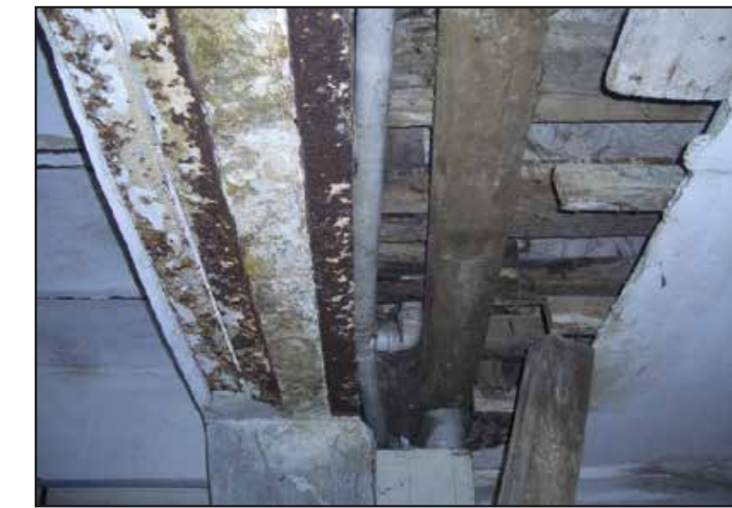
Mekanındaki düşük döşemenin I profillerinde oluşan korozyon
