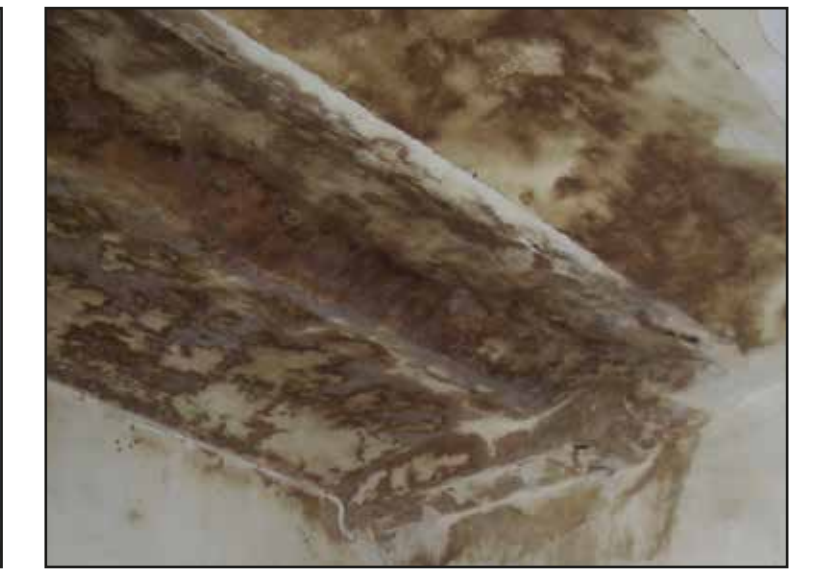
Mekanın volta döşemesinde oluşan rutubet izi
